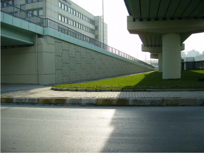
Şekil 18. Davutpaşa Kavşağı RE-Donatılı zemin duvarları (Reinforced Earth İnşaat Proje ve Ticaret A.Ş., 2006)
