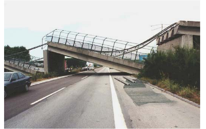
Şekil 14. RE-duvar ve Arifiye Köprüsü (1999 Gölcük Depremi sonrası). Yatay deplasman 350cm, düşey deplasman 45cm.
